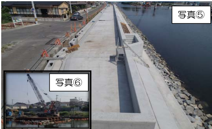
旧砂押川C工区(橋本橋～貞園橋間左岸)は、貞園橋方向より表法、裏法被覆工の施工を行っています。B工区は舗装工を行い完成です。A工区は、天端被覆工と同時に起点側の被覆工を行っています。E工区船溜まり場については、水管橋の基礎を栈橋を設置して撤去を行っています。
